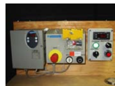
Quadro elettrico - Inverter
